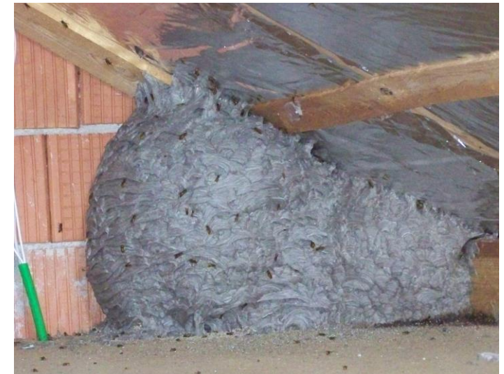
Ein großes Wespennest im Dachboden
